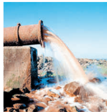
Vertido de aguas contaminadas.
